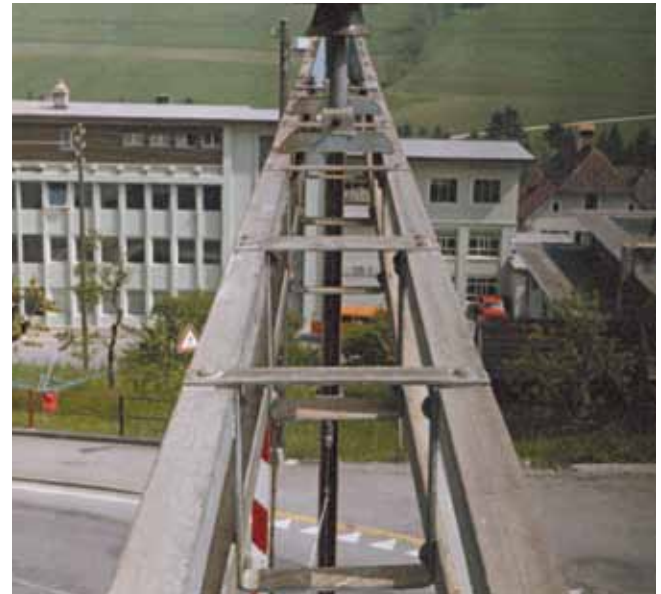
SBB-Fahrleitungsmast, 1930 – 1984, Renan Zinkschicht nach 54 Jahren über 80 µm.
